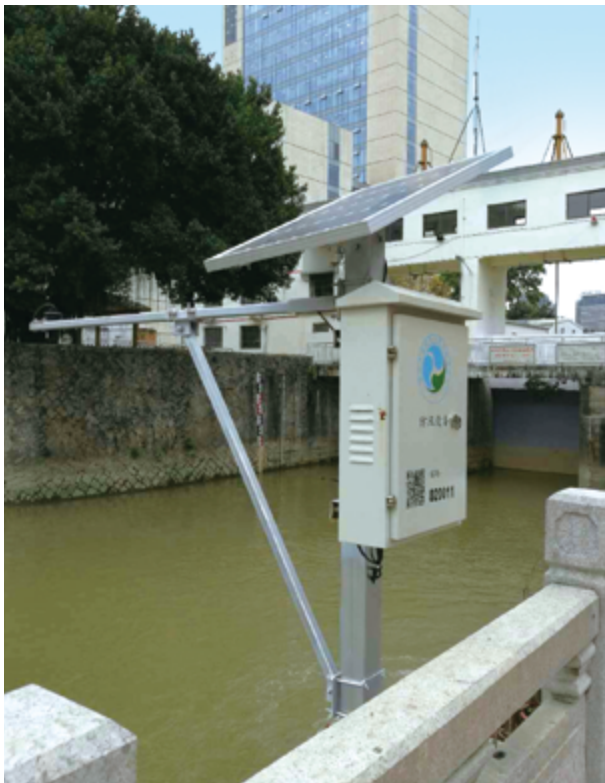
福州市台江区东风排涝站基于物联网的水位和流速监测点
