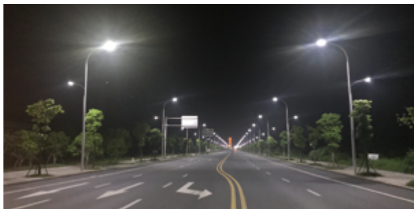
鹰潭市通过物联网控制的智慧路灯
